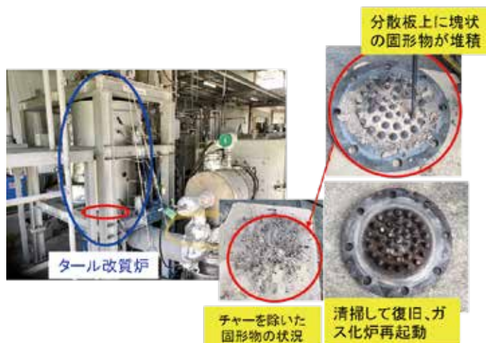
図9 分散板(タール改質炉)の固形物・閉塞状況・清掃後
