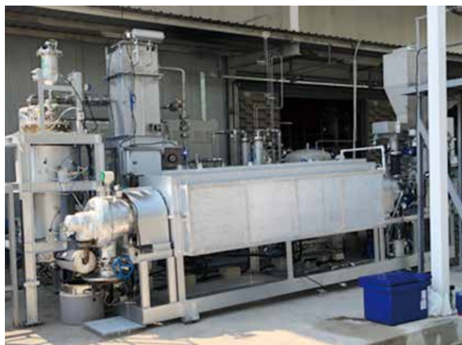
図3 ガス化炉(中央)及びタール改質炉(左側)
