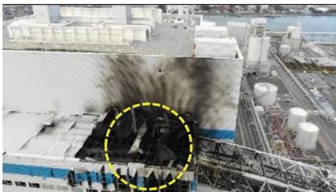
写真2 武豊火力発電所の事故による損傷
