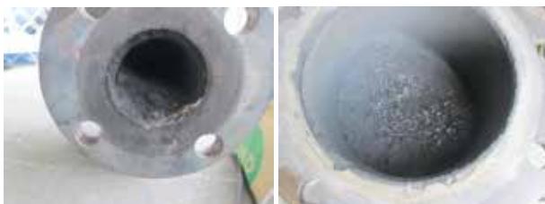
図8 タール改質炉入口配管(左図) 改質炉下部(右図)
