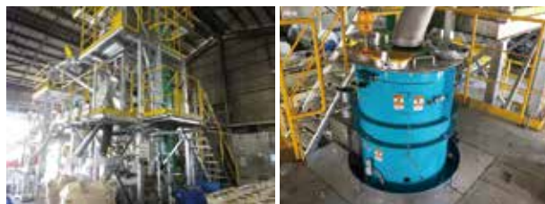
写真3 左: 建屋内設備 右: ペレタイザー
