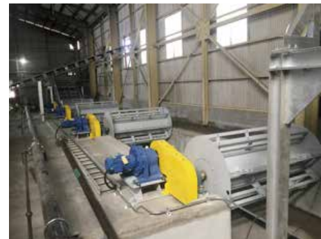
写真7 屋内チップ洗浄水路と水車（一部）
