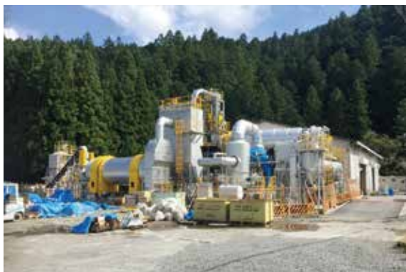
写真1 実証プラント外観
