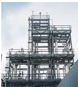
写真2 CO 2 変換メタノール生産プラント (出典: Carbon Recycling International 社ホームページ)
