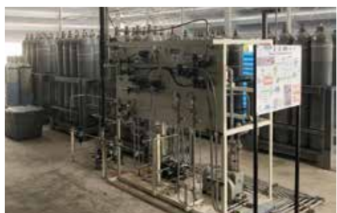
図4 高圧ガス圧縮装置およびガス貯蔵設備
