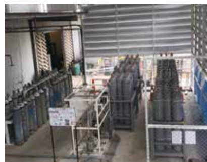
図5 高压ガス圧縮装置 および高压バッファシリンダ
