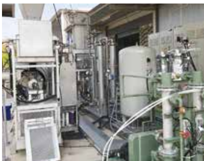
図4 ガス精製および 低压ガス圧縮装置
