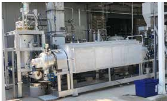
図3 ガス化炉およびタール改質炉
