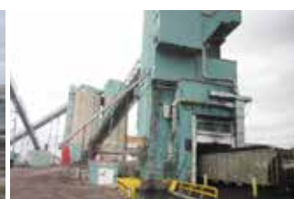
写真5 専用貨車への積出設備
