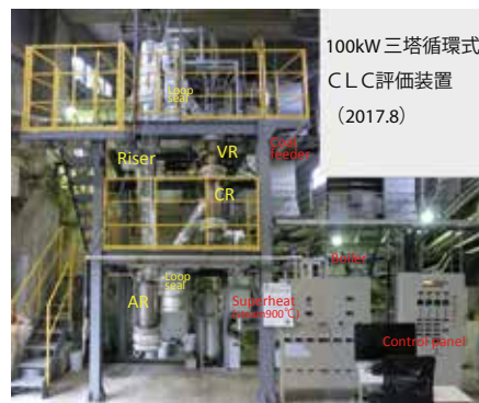
図 3 100kW 三塔式循環流動層 CLC 評価装置 (つくば産総研 (西) に設置)
