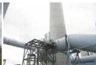
写真7 煙突前排ガスダクトから ITC 試験用の分岐座
