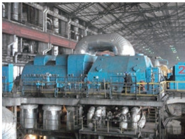
写真 2 DTEK 社ブルシュティンスカ発電所と同発電所の蒸気タービン
