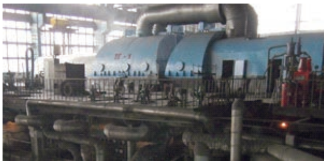
写真1 セントルネルゴ社トリピルスカ発電所と同発電所の蒸気タービン
