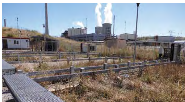
CO 2 漏洩影響試験設備(手前が農園、左上に分析室)
