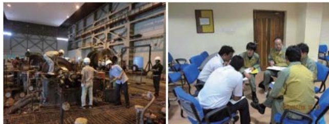
写真2 設備診断の様子
