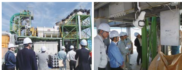
ガス化コージェネ設備 バイオコークス設備
