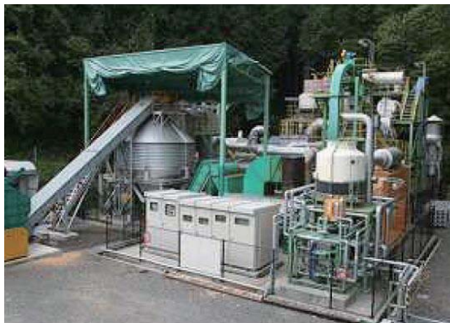
写真1 ガス化コジェネレーション設備
