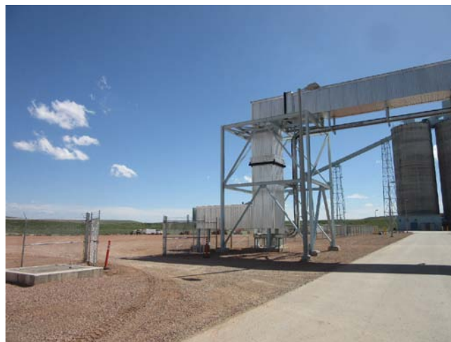
Dry Fork 発電所からの排ガスダクト (ダクト先端先が ITC 試験エリア)
