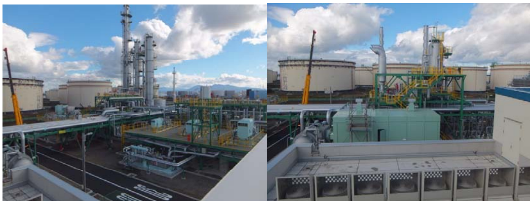
CO 2 回収プラント外観
