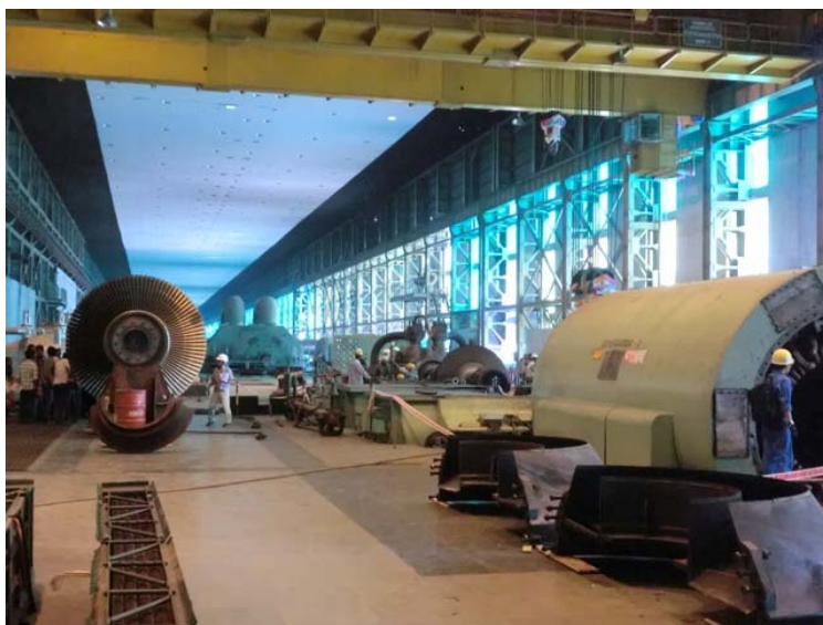
写真 6 タービン建屋内、解放点検中のユニット
