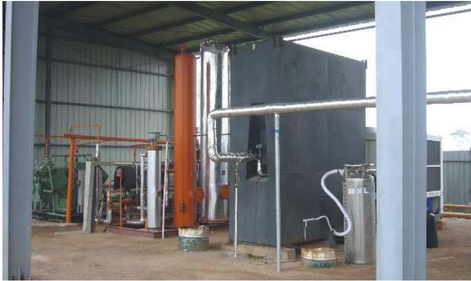
写真 炭鉱メタンガス液化試験装置
