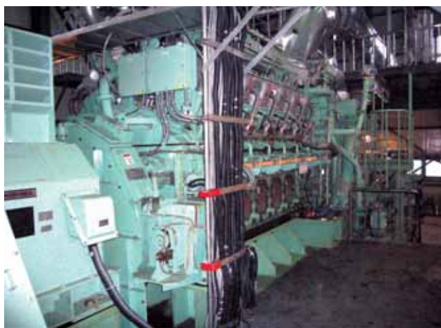
図11 撫順集団で試運転中の三菱重工のガスエンジン
