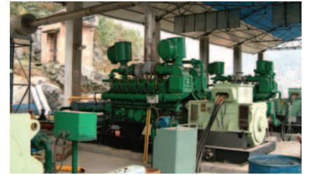
写真1 中国製ガスエンジン発電機 (500kW)
