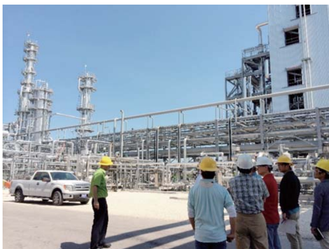
IGCCプラントに設置されたCO 2 回収装置
