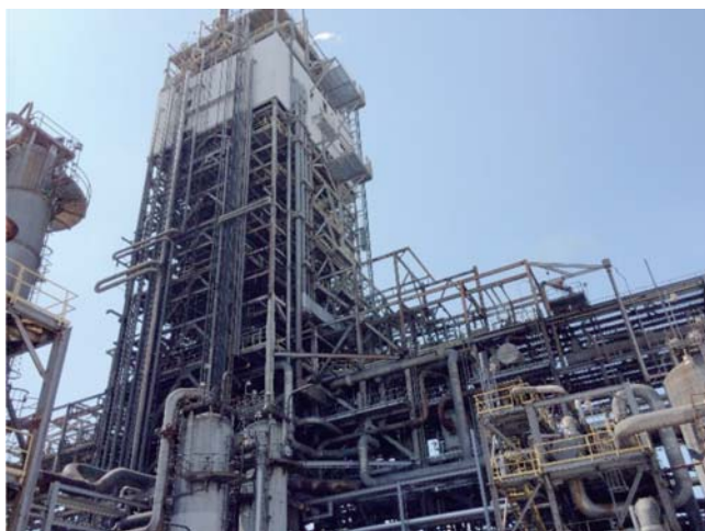
Polk発電所の250MW IGCCガス化炉部分(GE炉)
