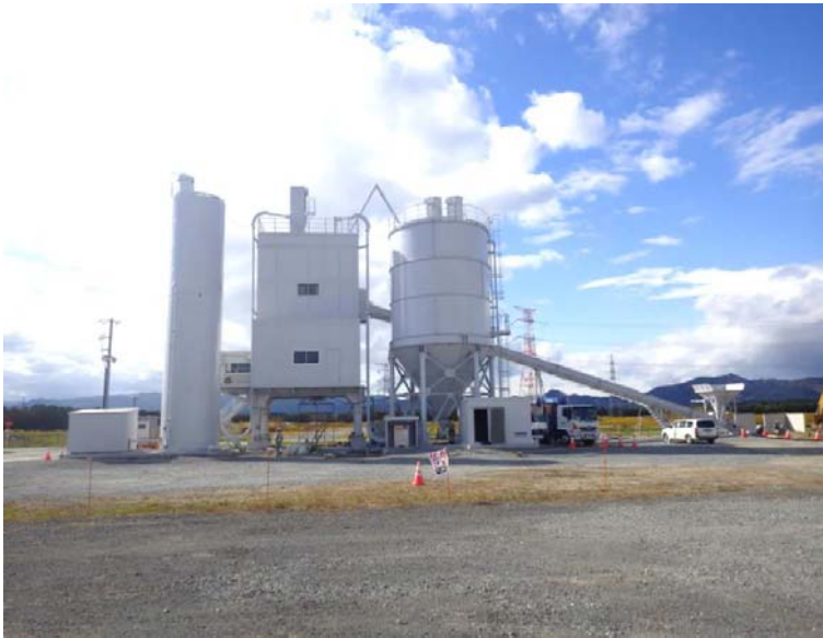
写真-2.4 塑性材（アッシュクリート TypeⅡ）の製造プラント例
