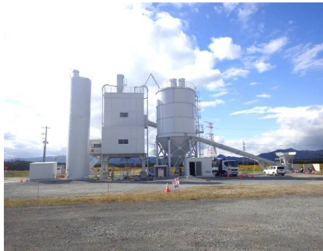
写真-3.6 石炭灰混合材料製造プラント
