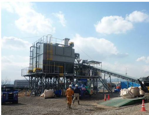
写真-3.2 石炭灰混合材料製造プラント
