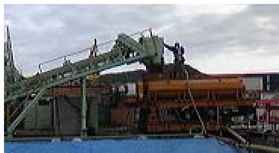
スラリー圧送ポンプ
