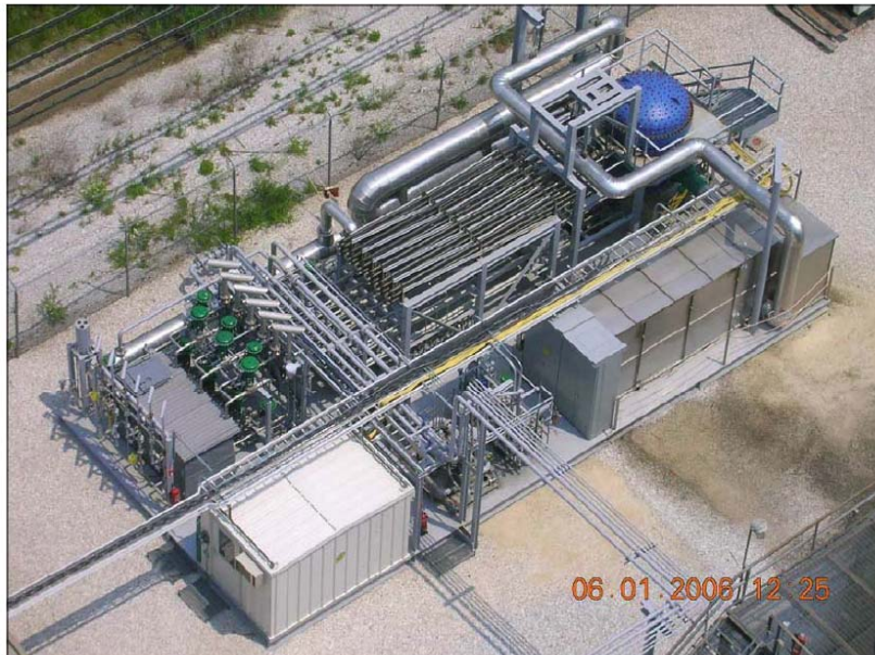
第 2 図 Engineering Prototype Facility(2005 年に開始された Air Products 社 Full Size Module)
