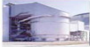
排煙脱硫装置
