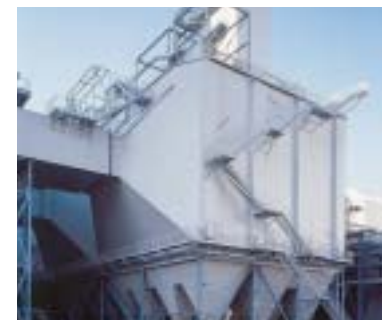
電気集塵器(Jpower磯子火力発電所)
