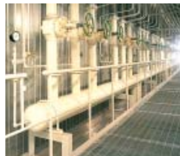
排煙脱硝装置(Jpower磯子火力発電所)
