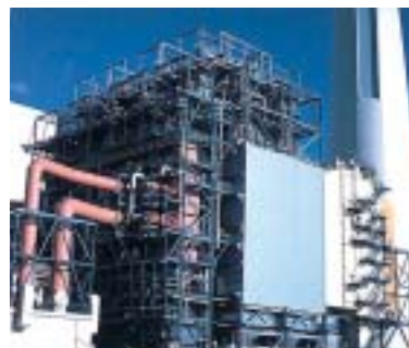
排煙脱硫装置(Jpower磯子火力発電所)
