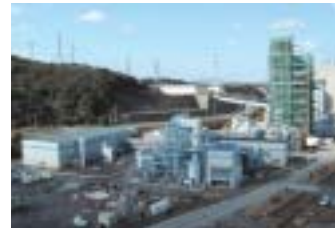
EAGLEパイロットプラント(150トン/日) 提供：電源開発株
