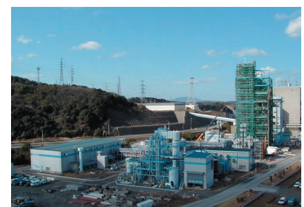
IGCCパイロットプラント電源開発株若松研究所
